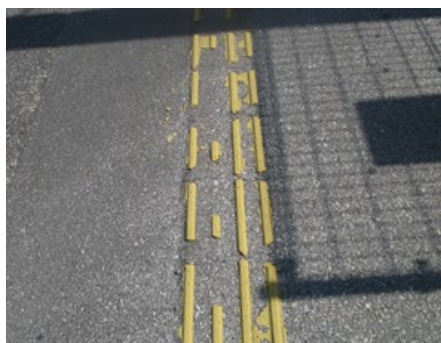
誘導用ブロックが摩耗・破損 (国道 329 号)
