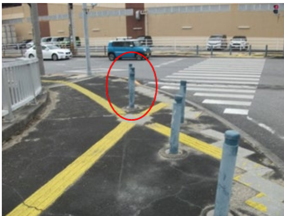
事例④-2 場所：県道249号 豊見城市（浜崎橋付近） 誘導用ブロックに車止めが近接
