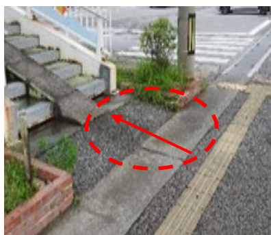
誘導用ブロックが未設置 (国道 58 号)
