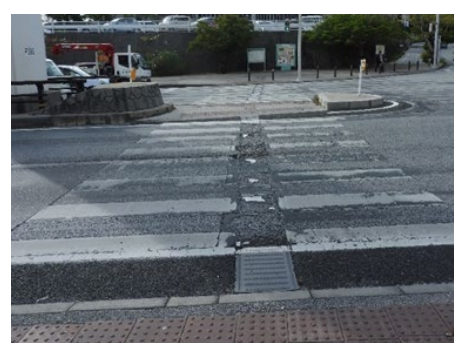
エスコートゾーンが摩耗・破損 (国道 330 号)
