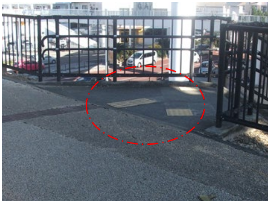
事例①-4 場所：国道330号 那覇市（古島インター） 階段前の誘導用ブロックが剥離している
