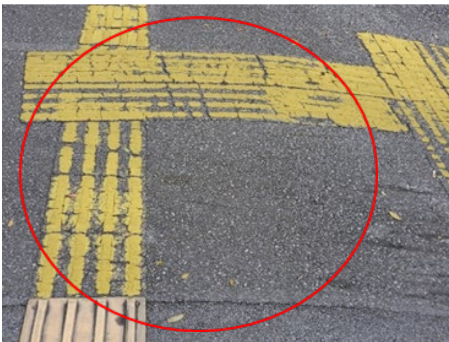
事例⑥-3 場所：県道29号 那覇市（安里1丁目交差点付近） 摩耗・破損している
