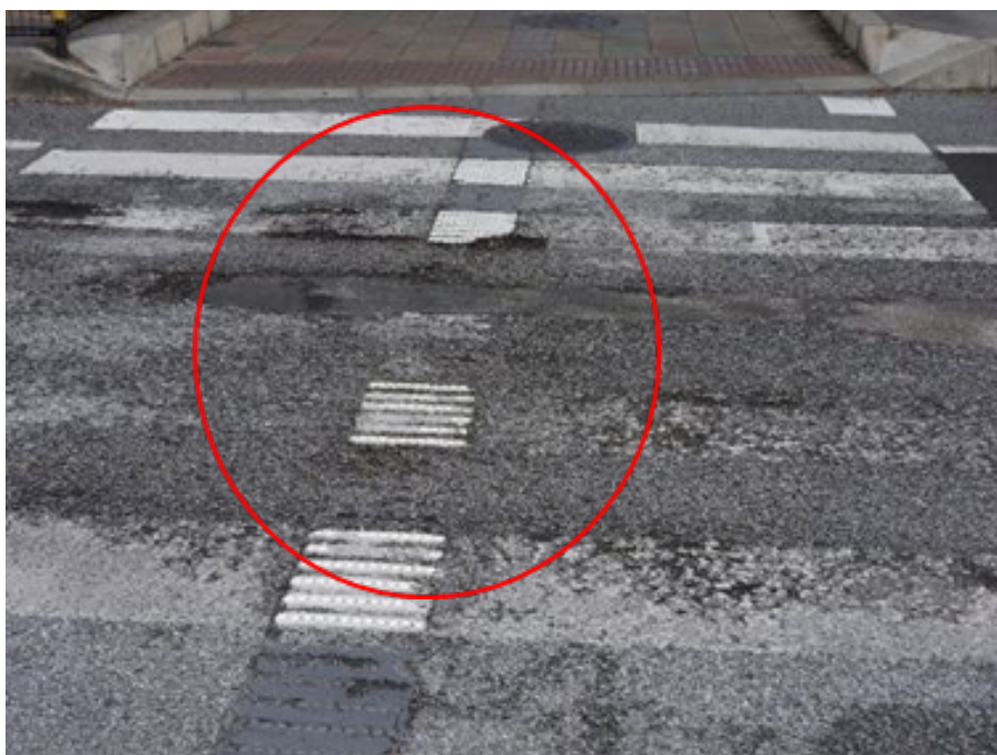
事例⑧-2 場所：国道330号 那覇市（安里交差点）
